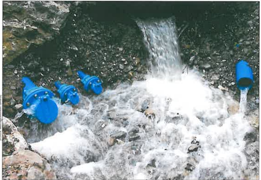
Trinkwasser in höchster Qualität: Die Stiegquellen in Götzis wurden neu gefasst.
